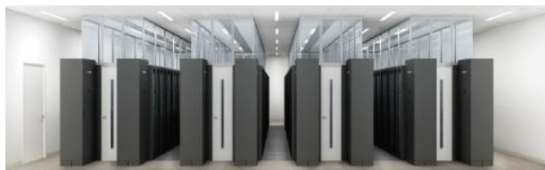
サーバールーム
