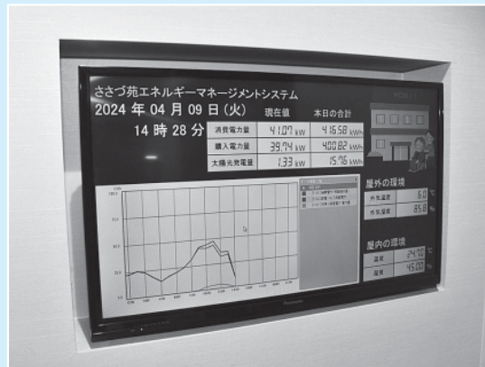
▲最先端の省エネルギー技術の活用により、光熱費は一般的な福祉施設と比較して約6割の削減を実現する
